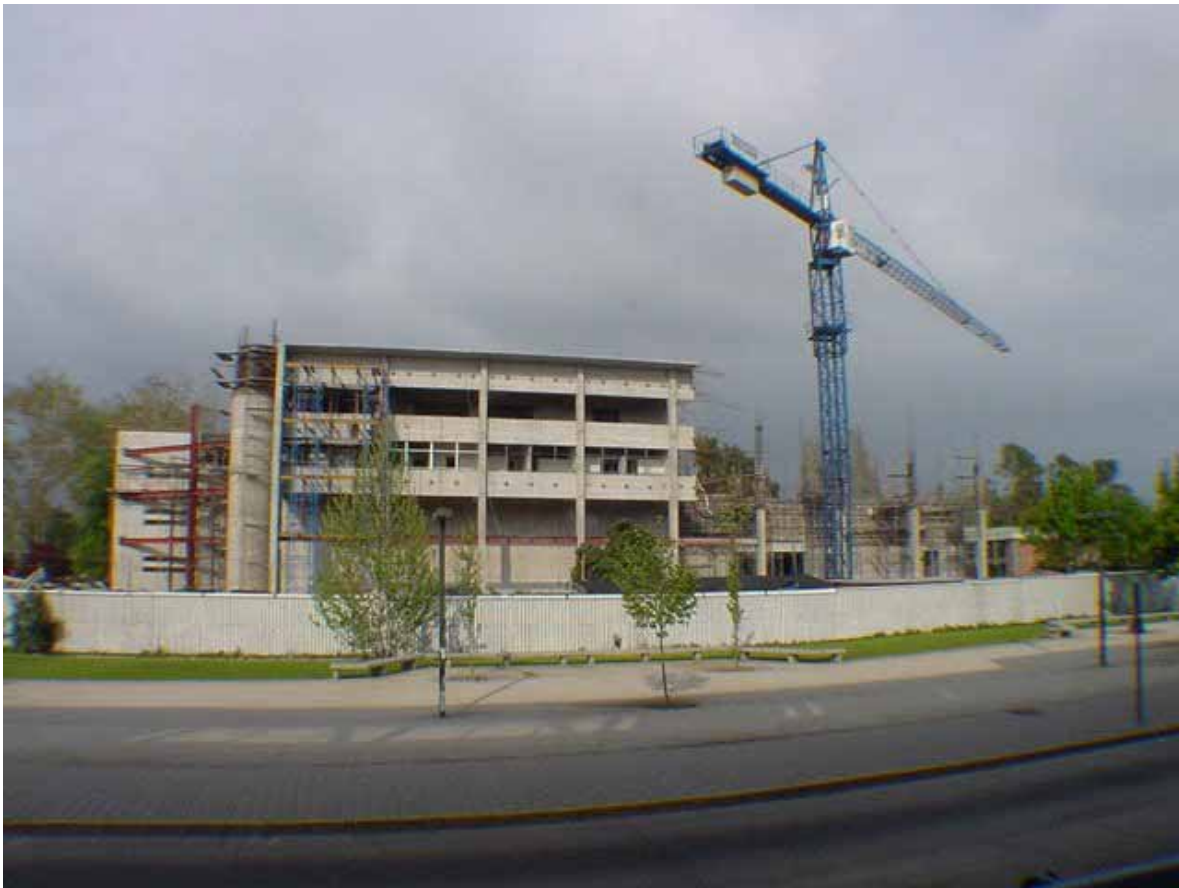
Fig. 2 Construcción del Edificio San Agustín de la Facultad de Ingeniería de la Universidad Católica
