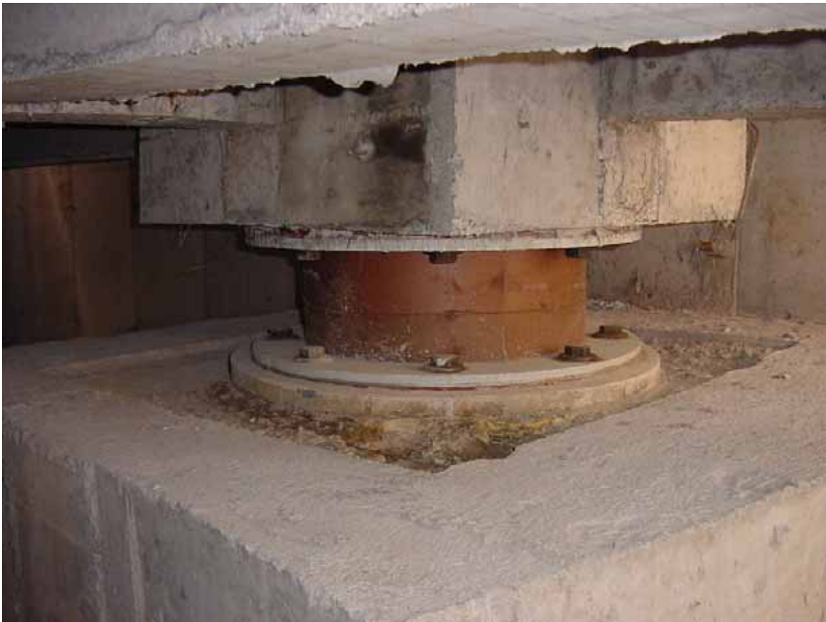
Fig. 4 Aislador del Edificio San Agustín
